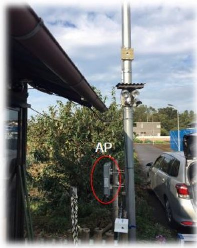
図3 基地局（AP）の設置状況
